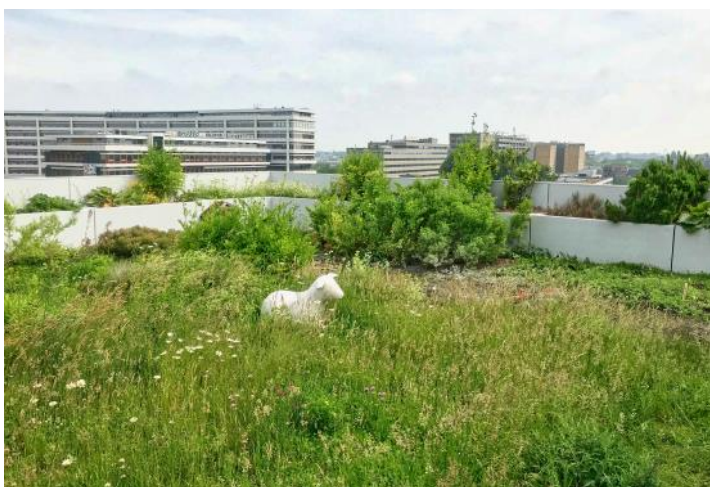
Op Het Dak, semi-intensive green roof, Rotterdam Photo: Dusty Gedge
